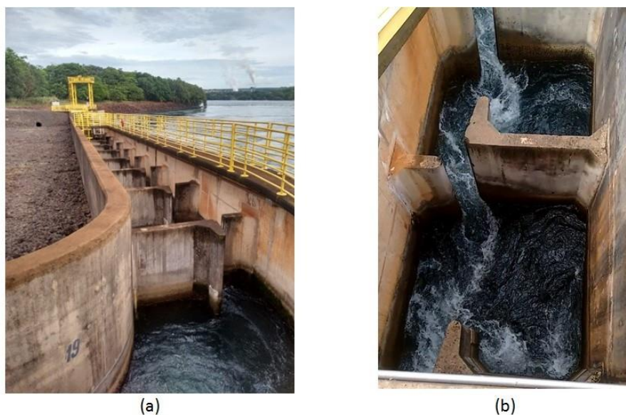
Figura 1: Escada de Peixes da UHE Igarapava. (a) Vista na jusante e (b) Escoamento nos tanques da estrutura principal. Fonte própria.
